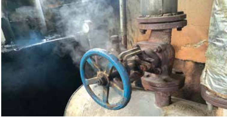
RÒ RỈ HƠI CỦA NỒI HƠI
